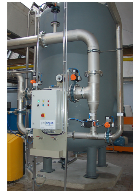
Mehrschicht-Kiesfilteranlage - Oberflächenwasser Durchsatz 50 m 3 /h
