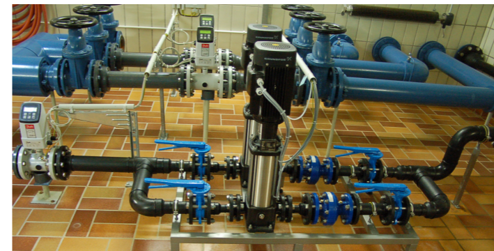
Redundant ausgeführte Druckerhöhungsanlage, 7 m 3 /h
